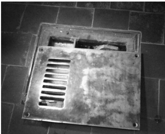
Foto 1: Rejilla con trampa de gas.
