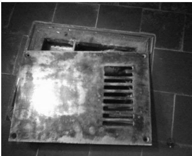
Foto 2: Rejilla con trampa de gas con la tapa MAL colocada. De esta forma la trampa de gas NO funciona.
